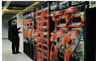
物理ネットワーク接続を確認
